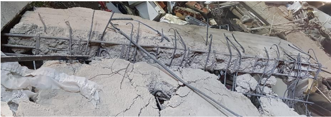
Şekil 3.18 – Doğanlar Apartmanı'nın bir kolonu
