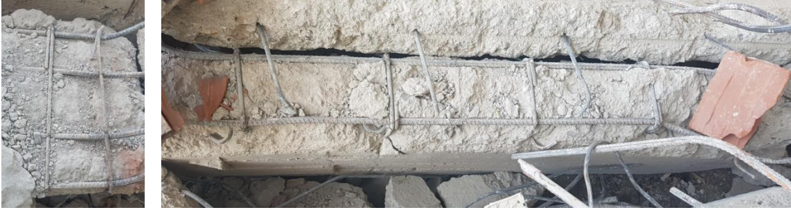
Şekil 3.17 – Doğanlar Apartmanı'nın enkazındaki bazı yapısal elemanların donatı detayları
