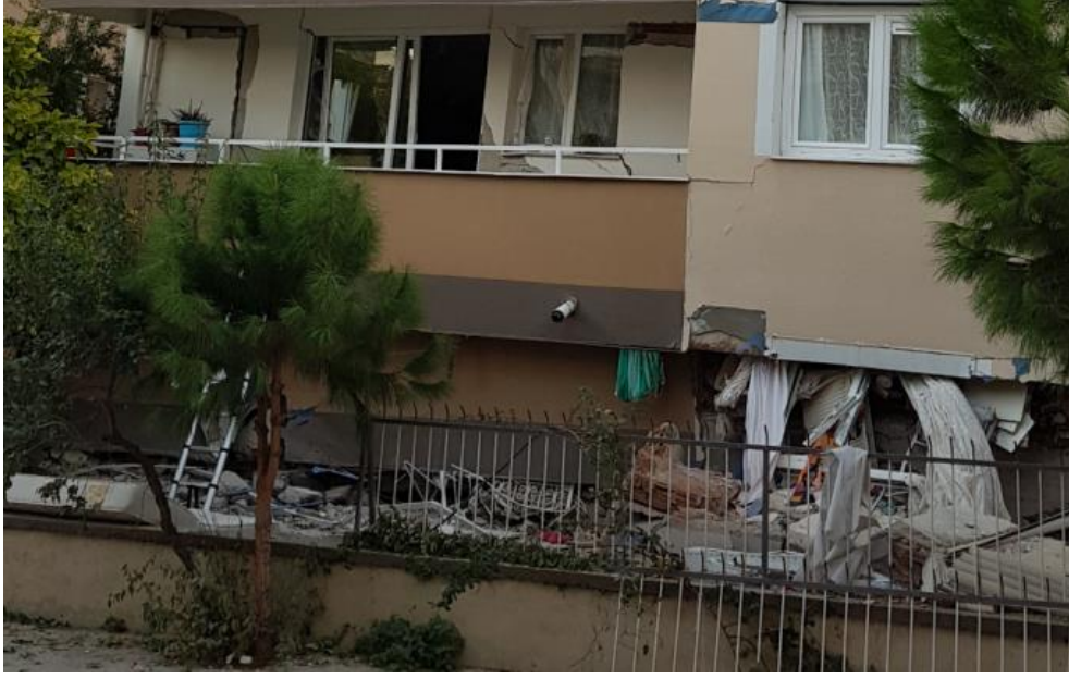
Şekil 3.48 – Barış Sitesi enkazı (arka görünüm)
