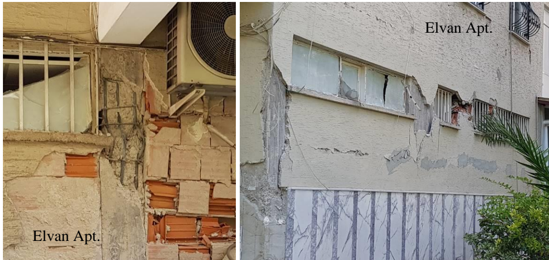
Şekil 3.72 – Kısa kolon oluşumu nedeni ile ağır hasar almış bir bina
