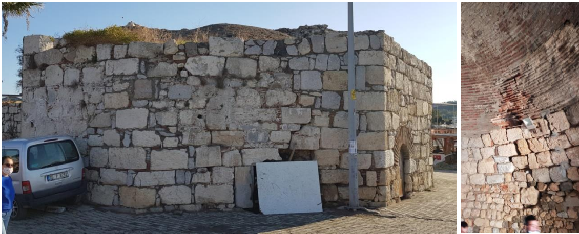
Şekil 5.9 – Tarihi kubbe yapısı ve iç kısmındaki dökülmeler
