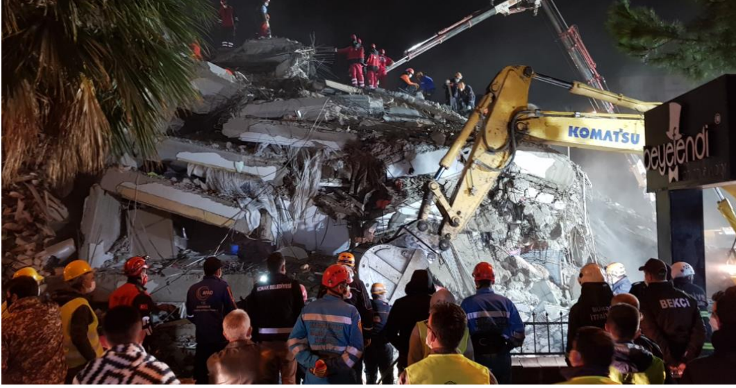
Şekil 3.22 – Emrah Apartmanı'nın enkazı (yan görünüm)
