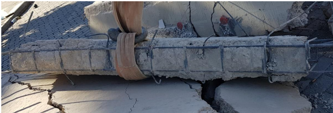
Şekil 3.11 – Rıza Bey Apartmanı'nda hasar görmüş bir kolon
