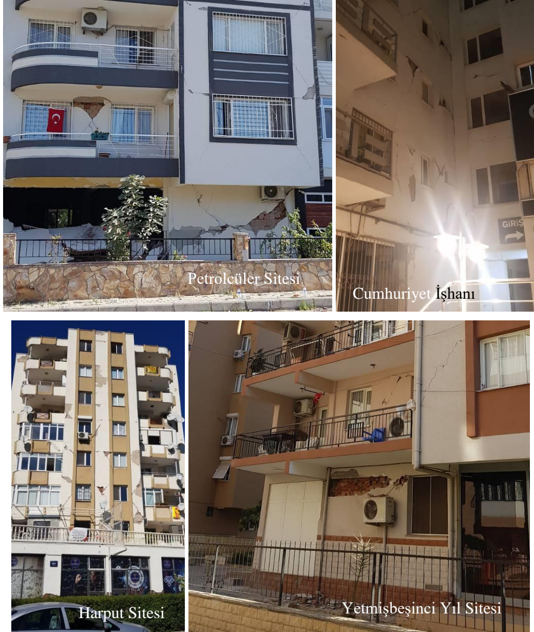
Şekil 3.52 – Yapısal ve yapısal olmayan elemanlar üzerindeki çapraz çatlaklar
