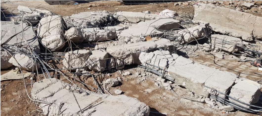
Şekil 3.24 – Emrah Apartmanı'nındaki hasarlı yapısal elemanları
