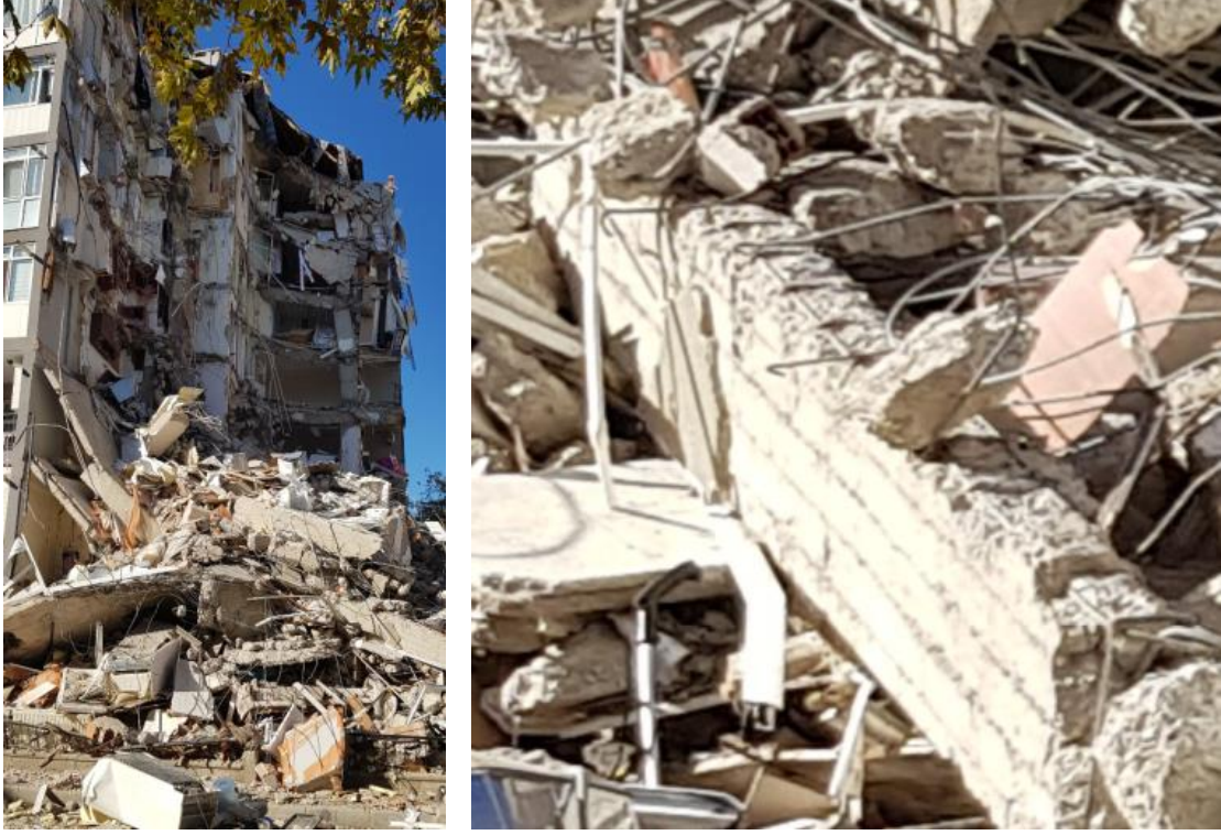
Şekil 3.41 – Karagül Apartmanı enkazı ve çeşitli donatı detayları
