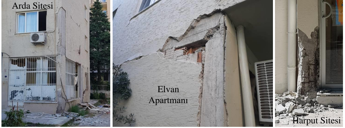
Şekil 3.53 – Ağır kolon hasarları
