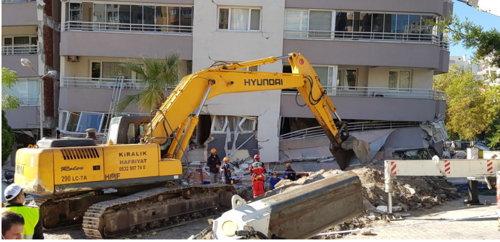
Şekil 3.34 – Yılmaz Erbek Apartmanı Kuzey Blok'un enkazı (ön görünüm)
