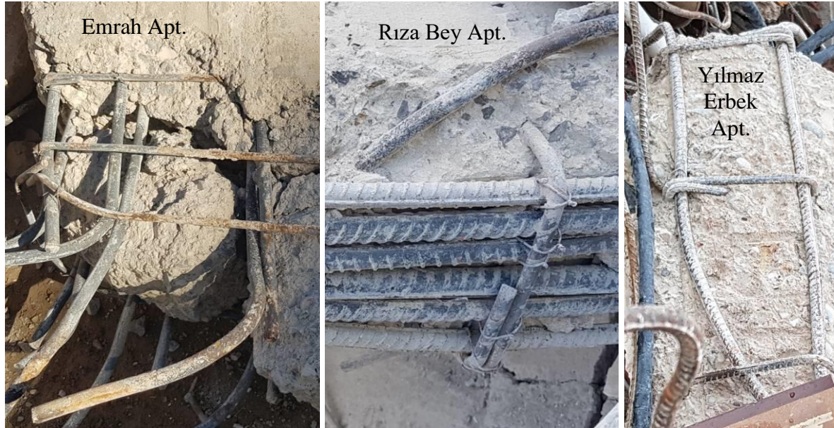
Şekil 3.57 – Yıkılan bazı binalara ait donatı detayları
