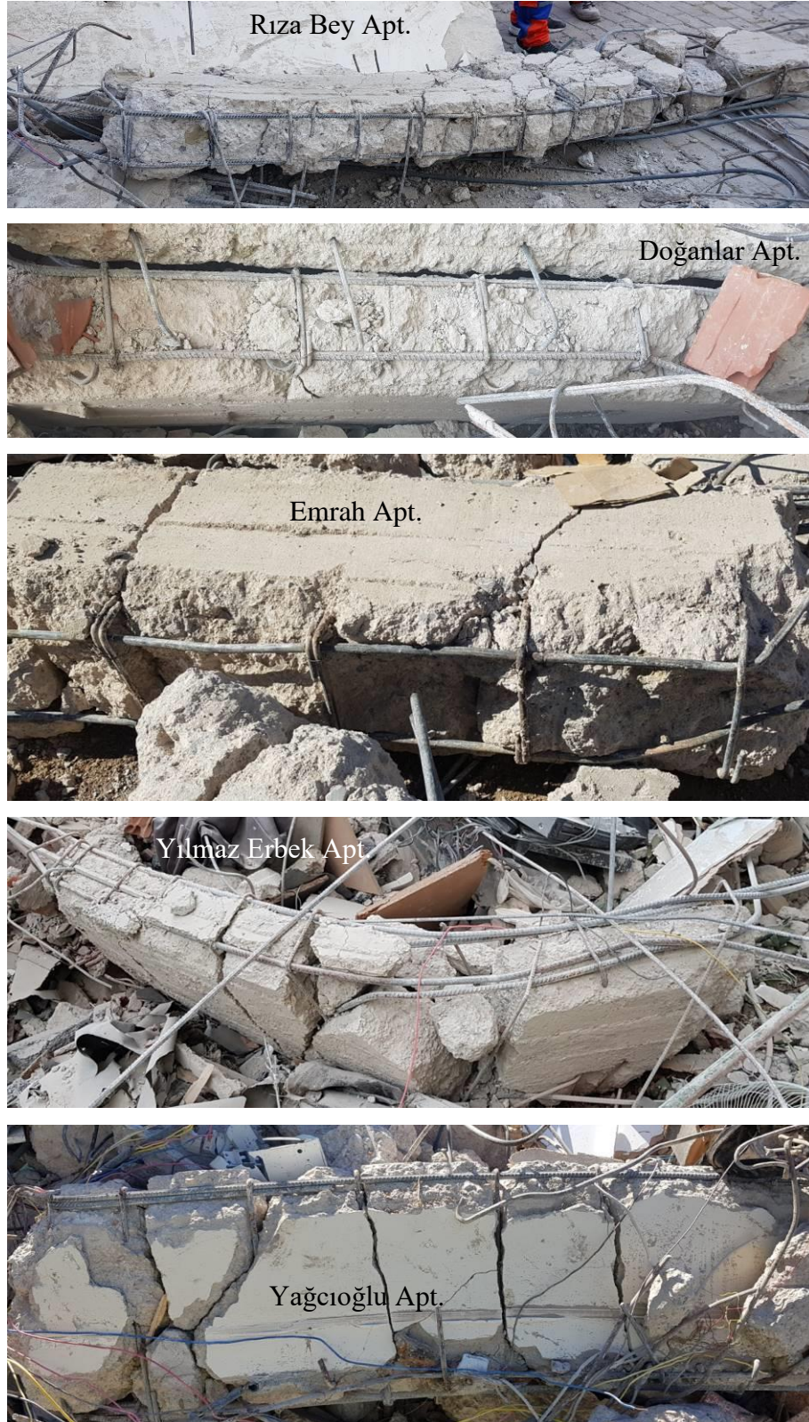
Şekil 3.59 – Yıkılan bazı binaların kolon ve kirişlerindeki donatı düzenlemesi
